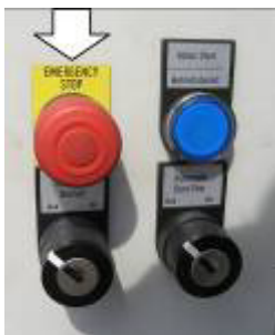
Afb. 14 a: NOODSTOP schakelaar (pijl) op de schakelkast
