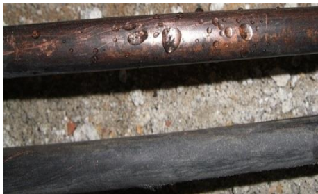
Beschadigde hydraulische leiding
