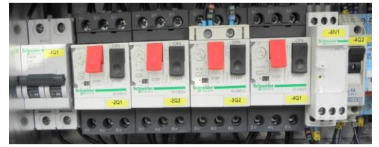
Figuur 43; Zekeringen en thermische automaten.
