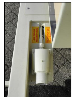
Figuur 38; Elektrische aansluiting.
